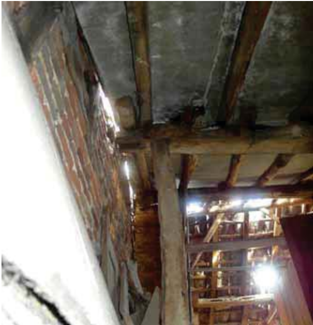
4. In PS28 kijkend naar zijgevel PS30 met linksboven raamhout
