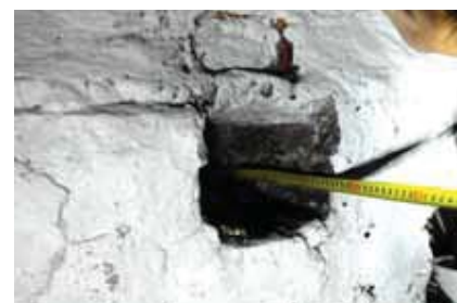
6. Gat in wand tegen Kritzraedthuis
