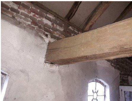
SP06 Z in muur opgelegde balk, geen stijlen of schoren
