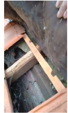
4. Overgang dak bij overstek dakschoor op gibbentplaat Bron: Nico de Bont / TBI
